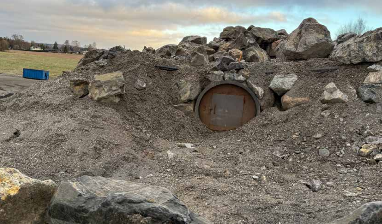
Spesialrør er anskaffet og gravd ned på området. Disse er utstyrt med dører, innganger og ventilasjonssjakter slik at ulike hundesøkssituasjoner kan simuleres.
