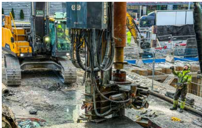
Her er det like før et nytt foringsrør skal sveises på. Boreriggoperatøren dirigerer gravemaskinføreren slik at foringsrøret blir senket riktig ned.
