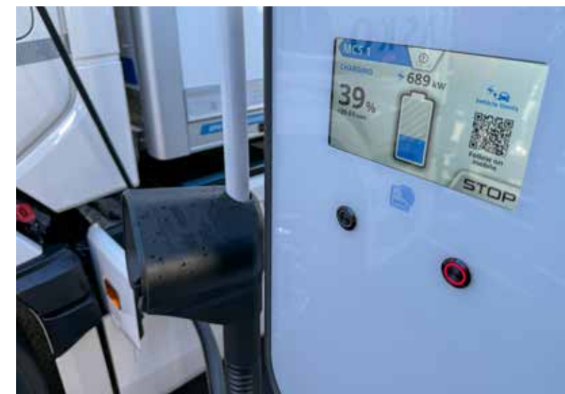
Ladestasjonen kan levere hele 1000 kW, men Scaniaen er foreløpig ikke klargjort for å ta imot mer enn 750 kW.
