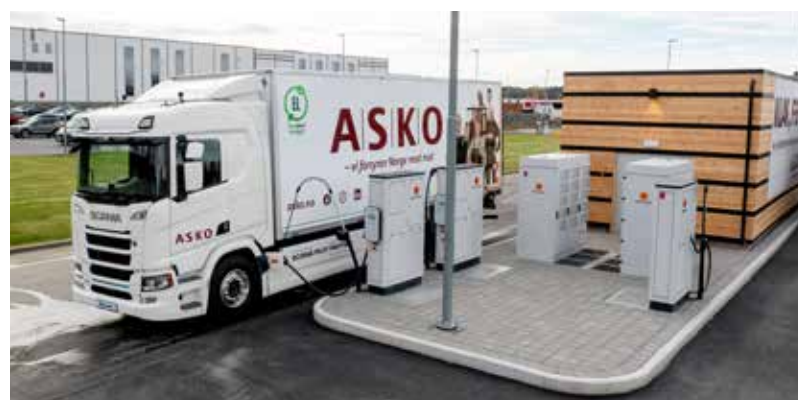
Det nye ladeanlegget som Asko har etablert, har til sammen to ladepunkter for MCS og fire ladepunkter for CCS2. De to for MCS har en maksimal ladehastighet på 1,2 megawatt, hver mens de fire CCS2-kontaktene er på 560 kW.
