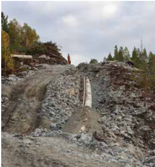
Rørene som vannet til kraftstasjonen går i har en diameter på 1400 mm.
