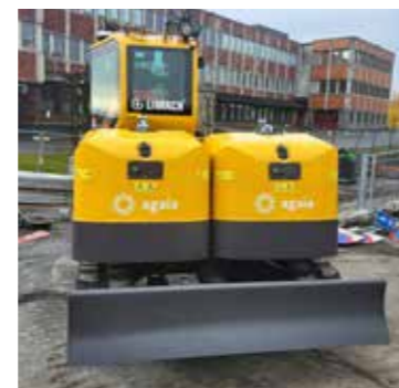
Maskinen er satt i drift på et gateopprustningsprosjekt for Bymiljøetaten på Ensjø. (Foto: Agaia)
