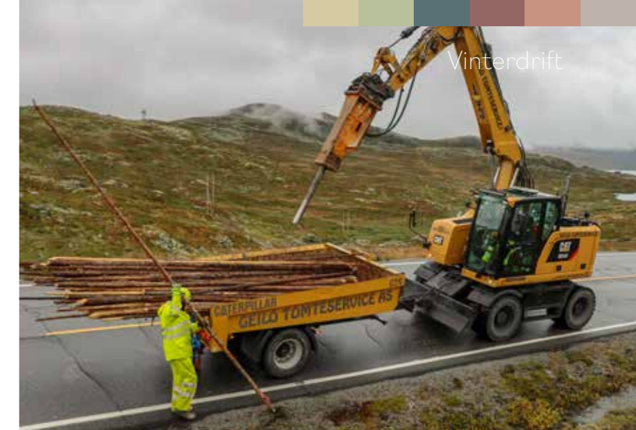
Tore Skogheim fra Geilo Tomteservice pigger hull til de fem-seks meter lange trestammene som brukes som brøytestikker over Hardangervidda. Olav Johan Dale har jobben med å løfte brøytestikkene ut av hengeren og plassere dem i hullet.
