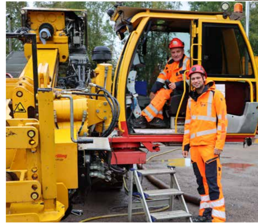
Leif Dreier-Engtrø (i førerhytta), formann, og Kristian Olimb, driftsansvarlig, begge fra Olimb Anlegg. Selskapet har trukket mange hundre meter VA-ledninger på prosjektet.
