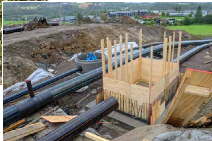
Det bygges pumpestasjoner to steder på den vel 10 kilometer lange strekningen. Det bygges også tre salgskummer for vannforsyning til kommunalt nett.
