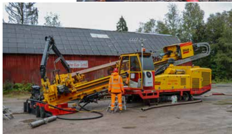
Leif Dreier-Engtrø (i førerhytta), formann, og Kristian Olimb, driftsansvarlig, begge fra Olimb Anlegg. Selskapet har trukket mange hundre meter VA-ledninger på prosjektet.
