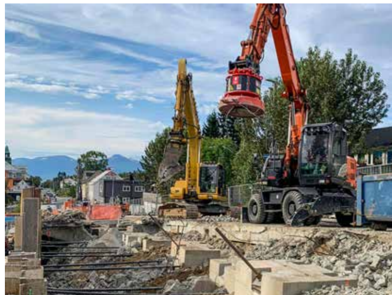
Knusing og sortering av betong og armeringsjern. Man kan tydelig se forankringsklossene, og stagene som går derfra og ut til spuntveggen. (Foto: Maskinentreprenør Herbjørn Nilssen AS)
