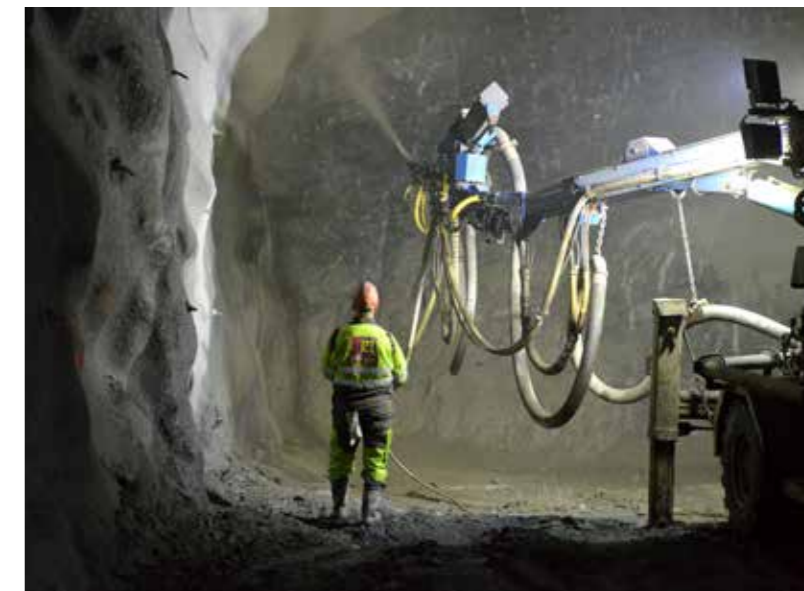
Økt bruk av sprøytebetong, som her i Eiganestunnelen i Stavanger, er ett av tiltakene som kan gjøre det billigere å bygge tunneler. (Foto: Øyvind Ellingsen/Statens vegvesen)
