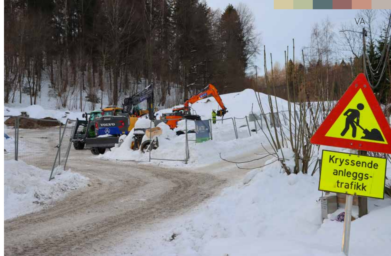
KORTREIST: Alle masser mellomlagres på dette området, som kun er noen få meter fra selve anlegget, og som var et landbruksareal i dårlig forfatning. Massene som ikke blir gjenbrukt i prosjektet, skal brukes til å bygge opp igjen landbruksarealet slik at dette blir bedre enn det var tidligere.
