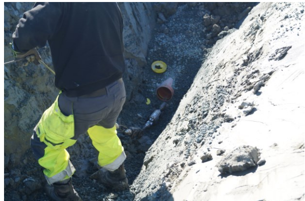
Figur 23 Rørkontroll med filmkamera. Foto: JMSH
